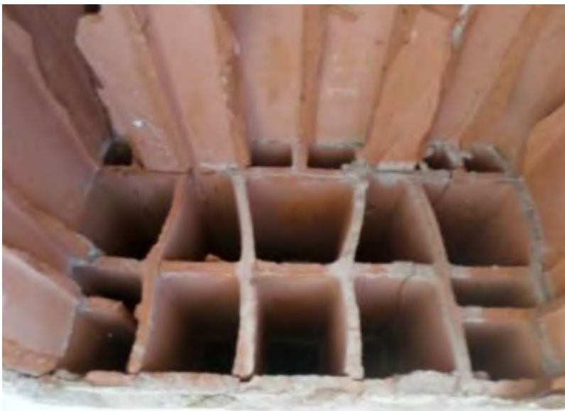
Figura 6 Sfondellamento dei solai: immagine delle lesioni e fessurazioni presenti all'interno di una pignatta prima del manifestarsi dello sfondellamento
