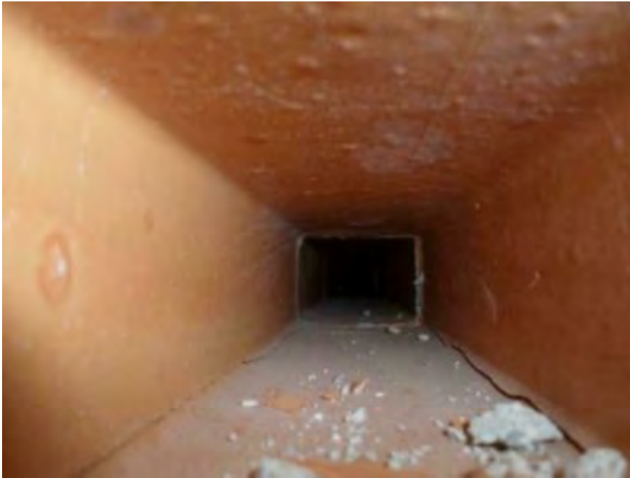
Figura 8 Sfondellamento solai: endoscopia all'interno di una camera di pignatta con evidenti lesioni e distacchi tra fondello e setti verticali della pignatta
