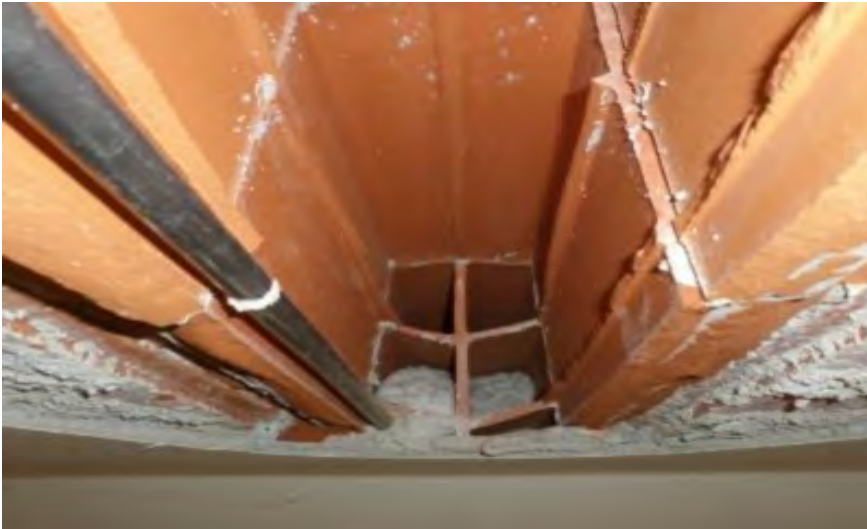
Figura 5 Sfondellamento solai: nell'immagine si nota la rottura del fondello a causa della realizzazione di tracce per inserimento di un impianto
