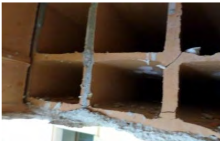
Figura 7 Tranciamento setti e distacco fondelli: segni di distacco del fondello dai restanti setti verticali della pignatta
