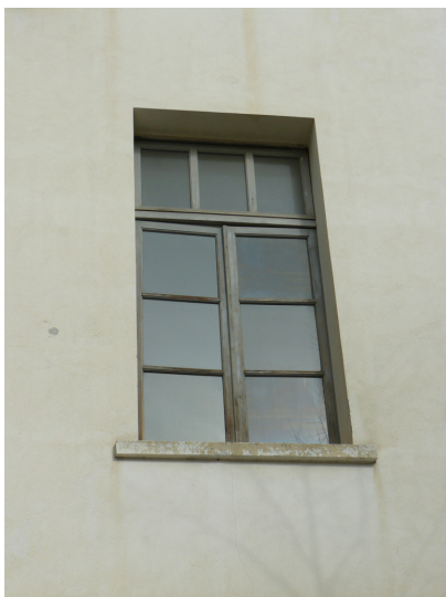
FOTO N.3 Infisso in legno da sostituire
