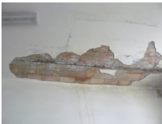
FOTO N.4 Travetto solaio fatiscente
