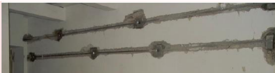
Figura 8 . Tirantature binate (catene realizzate tramite CAM)
